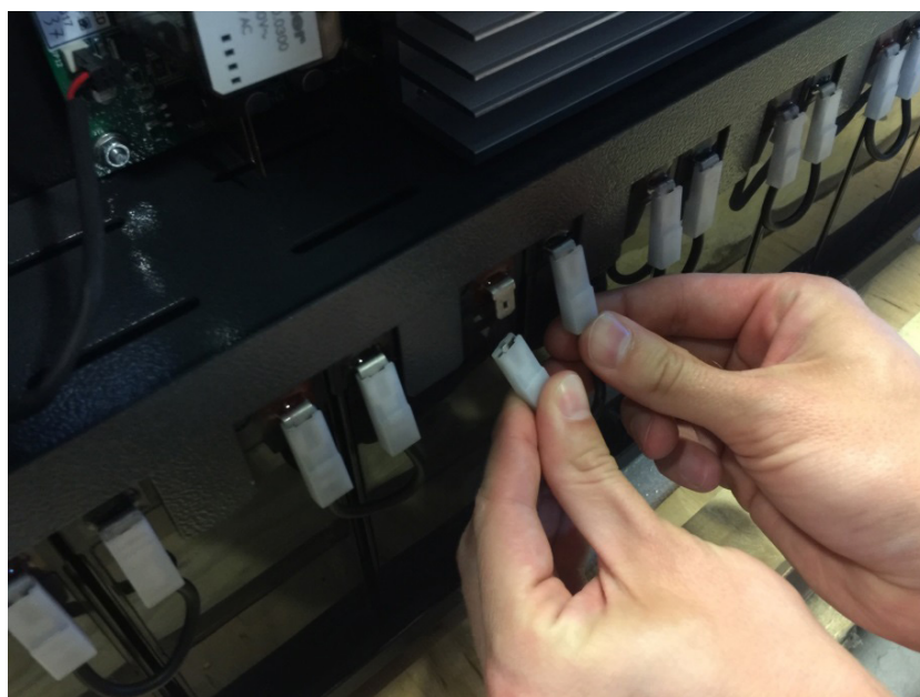
Рисунок 10. Электрическое соединение батарей с помощью перемычки
